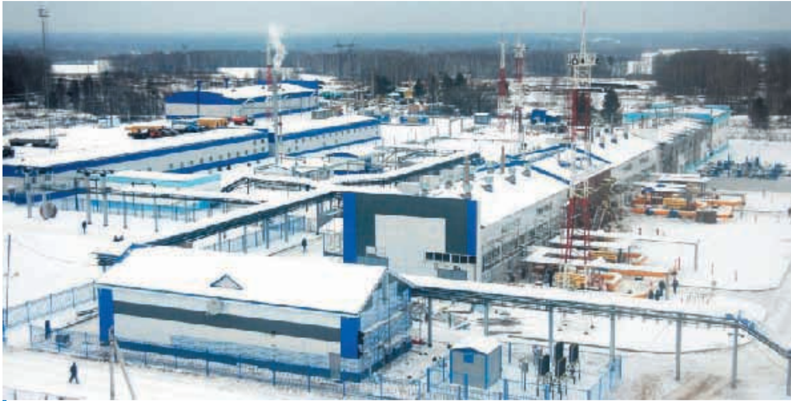
Компрессорная станция в Володино на сегодняшний день самая технически перевооружённая в Обществе. Реконструкция станции практически завершена. По программе реконструкции электроприводных КС все 6 станций будут модернизированы
